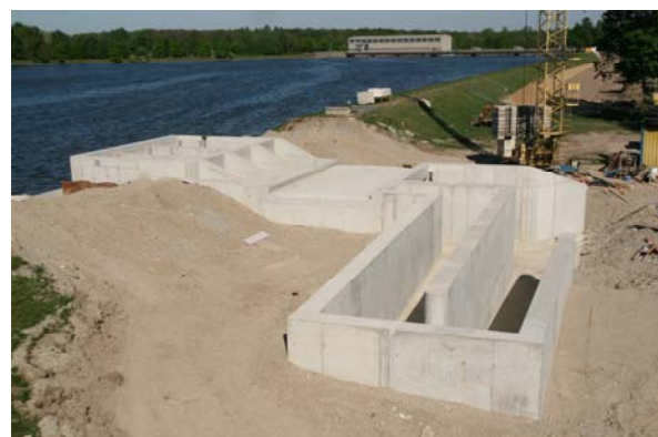
Abbildung 1: Rohbau des Ausleitungsbauwerk für das Dynamisierungsprojekt. Vorne rechts der "vertical slot"-Pass für den Fischaufstieg, hinten links die drei Ausleitungskammern zu Steuerung der Durchflussmenge von 0,5 bis 5,0 cbm/sec. Im Hintergrund die Staustufe Bergheim.
